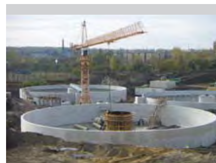
Oczyszczalnia ścieków Katowice
